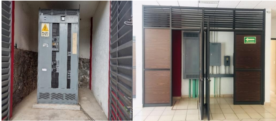
Img. 35 Instalaciones eléctricas
